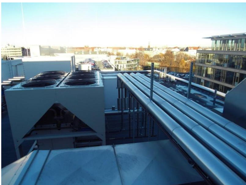
Splitkälteanlage mit Kältemittelleitungen
