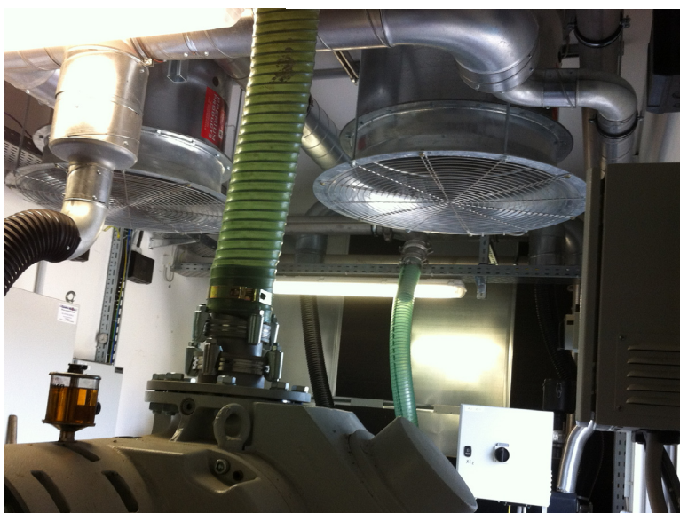
Innenansicht Ventilatoren mit Vakuumpumpe
