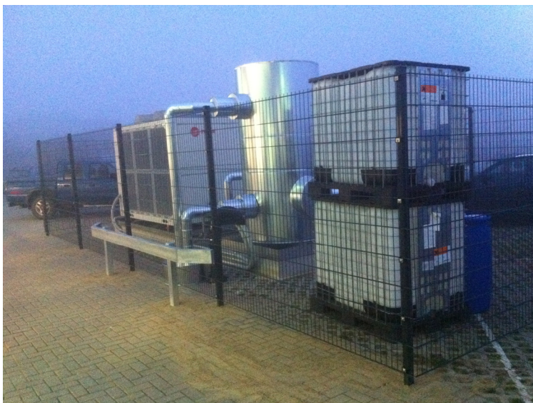
Ansicht Kaltwassersatz mit 150kW Kälteleistung
