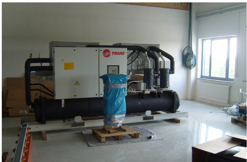
Schraubenverdichter Kältemaschine luftgekühlt mit einer Kälteleistung von 342 kW
