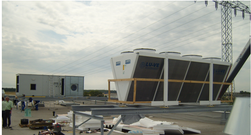
Zuluftgerät mit 40.000 m³/h / Kältemittelverflüssiger mit 445 kW
