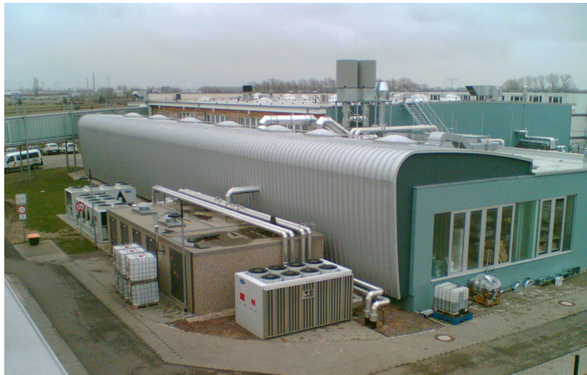
3 luftgekühlte Kältemaschinen der Produktionslinien 1-3
