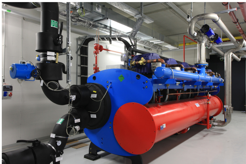
Eine von drei Kältemaschinen mit je 1,8 MW Kälteleistung
