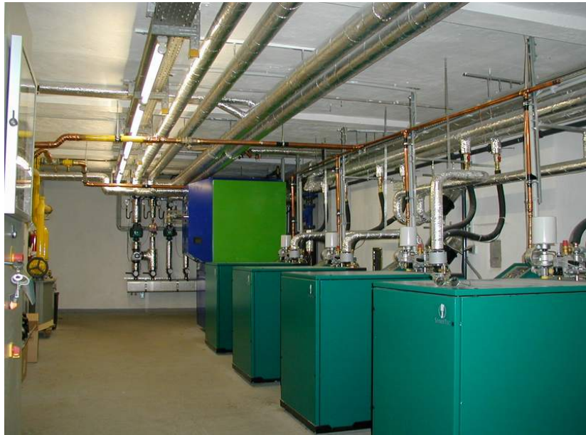
Heizzentrale mit erdgasbetriebener BHKW-Kaskade
