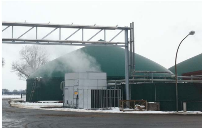
Kühlturm und Gärbehälter
