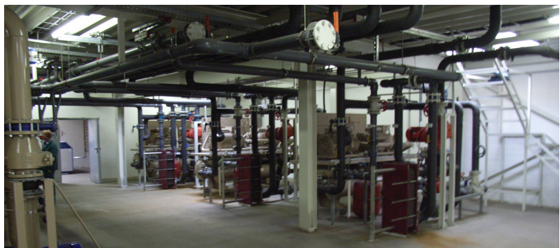
Hallenansicht und Kältezentrale
