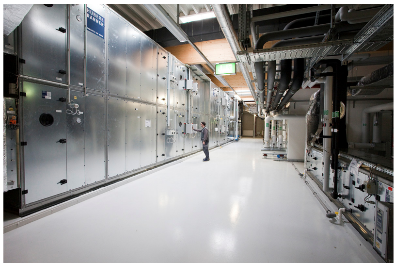
Lüftungs-Zentralgerät Waferfab 180.000 m³/h
